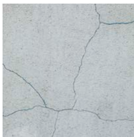
Cracking Surface พื้นผิวแตก
