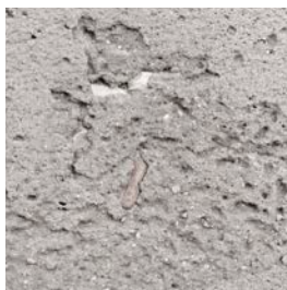
Peeling Surface พื้นผิวหลุดล่อน
